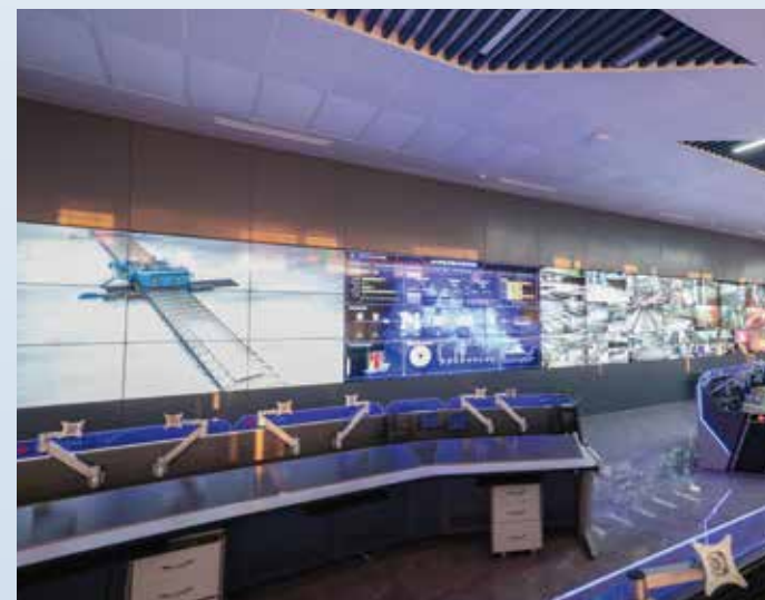
■ 数智化轧钢 鞍钢鲅鱼圈轧制集控项目 国内首条智能制造示范 人工智能应用示范中厚板生产线智能集控项目
