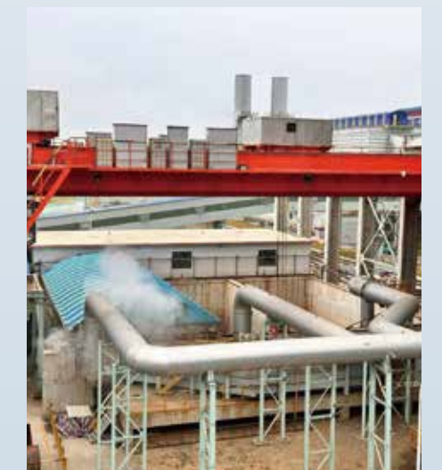
低碳冶炼 临沂优特钢环保底滤渣处理工程 采用新型模块化过滤单元 具备消纳废水、快速便捷更新滤料不停产功能 过滤池水位监测稳定、准确
