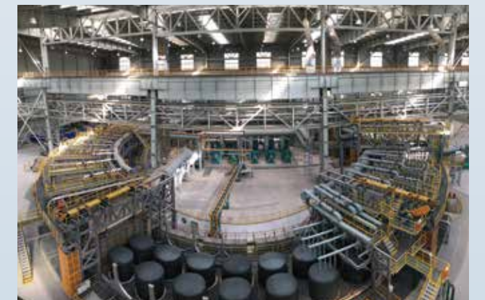
热处理炉 山西太钢不锈钢高端冷轧取向硅钢高温环形炉项目 硅钢高温连续退火工艺采用环形炉的设备全面实现国产化 世界上坯料装载量最大 年产量最大的硅钢盘卷高温退火热处理环形炉
